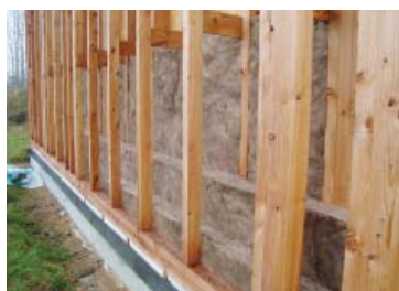
Obr. 5 Příklad vrstvené izolace do dřevěného roštu. Použity jsou nosníky, které neprochází skrze celou konstrukci a tudíž nevytváří tepelné mosty.
